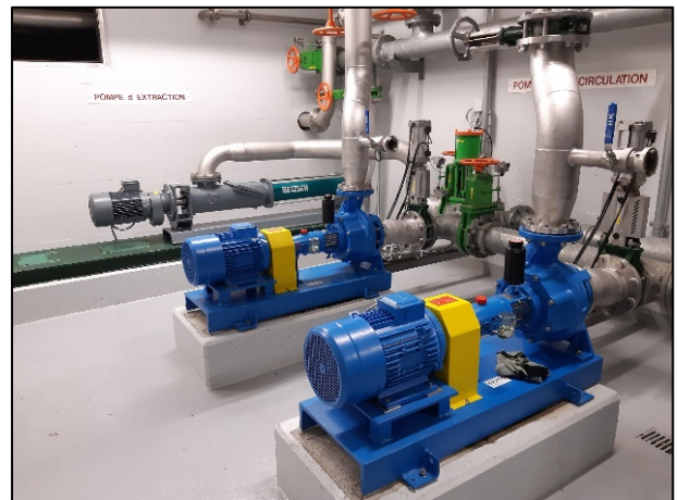
Les 3 nouvelles pompes
