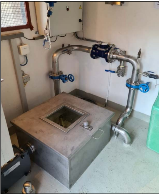
Nouvelle tête de puits de Prouvin
