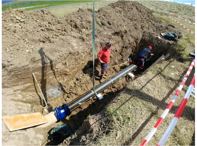
4. Rupture sur la conduite de transport à Farvagny
