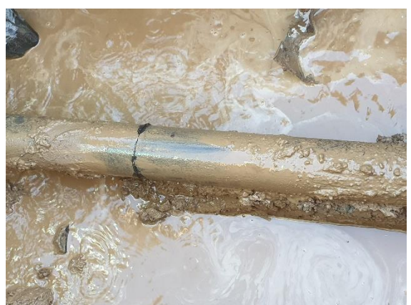
2b. Rupture radiale conduite en font grise
