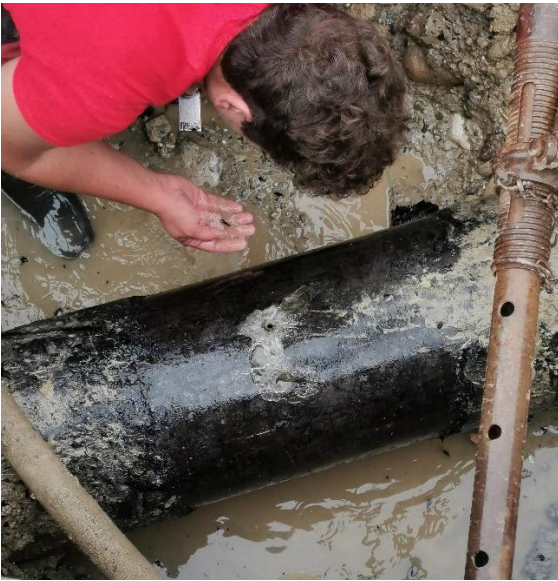
3. Exemple d'un tuyau corrodé
