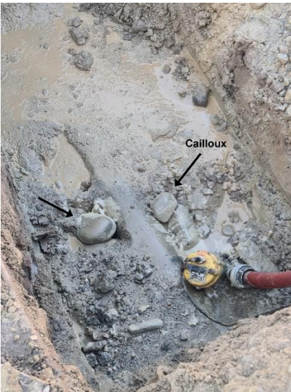
1c. Présence de cailloux sur la conduite
